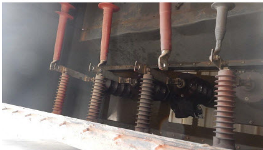
Slika 7.6: Izgled havarisane priključne kutije u kojoj se nalaze prolazni izolatori 33 kV transformatora
