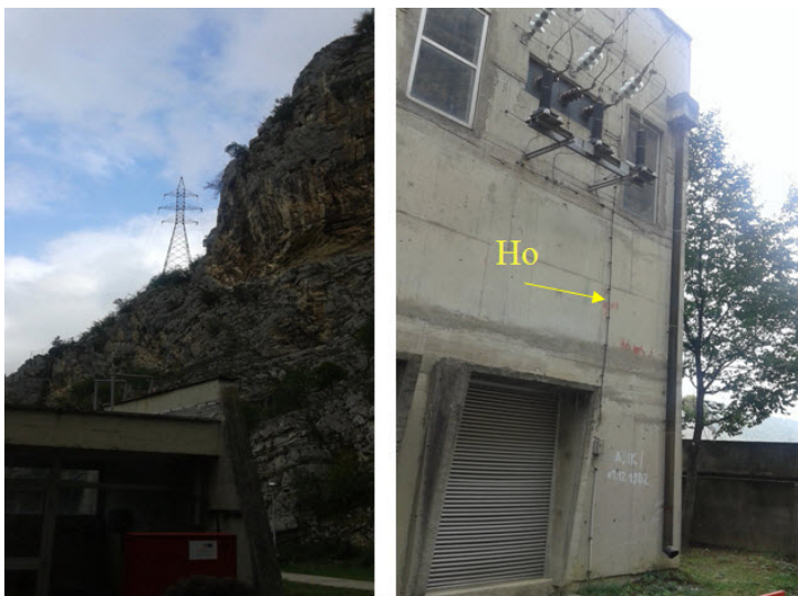
Slika 4.1: Prilazni dalekovid 35 kV (levo) i priključak na zgradi sa odvodnicima prenapona (desno)
