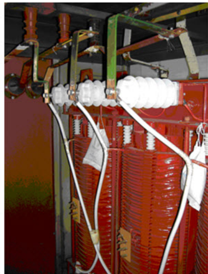
Slika 2.11: 1 Slike uljnog i suvog transformatora sa postavljenim odvodnicima prenapona sa silikonskim kućištima direktno na konstrukciji
