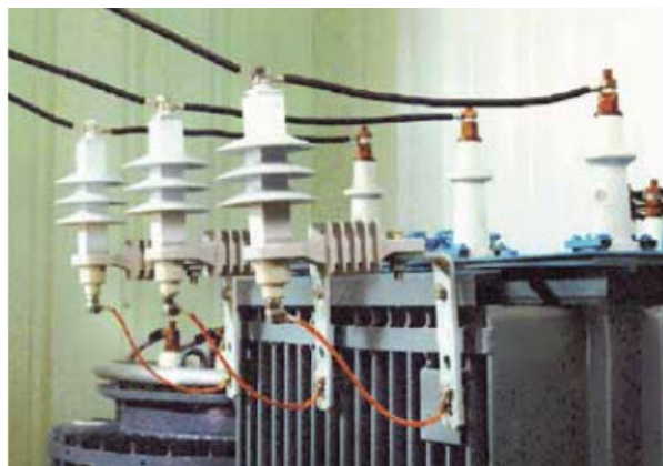
Slika 11.10: Primer instalacije odvodnika prenapona sa mrežnim odvajanjem direktno na transformatorski sud
