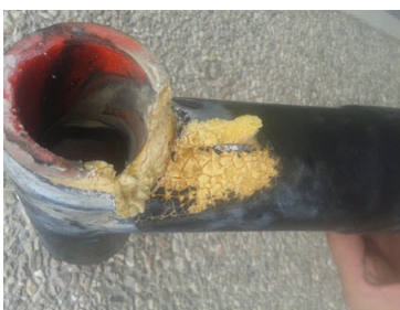
Slika E.9: Probijena kablovska završnica
