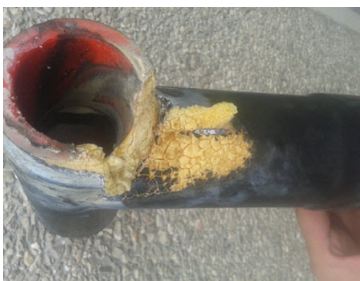
Slika E.9: Probijena kablovska završnica
