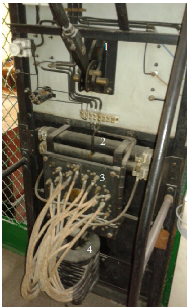
Slika 5.4: Zadnji deo komandne table za visokonaponski transformator sa regulacionim transformatorom
