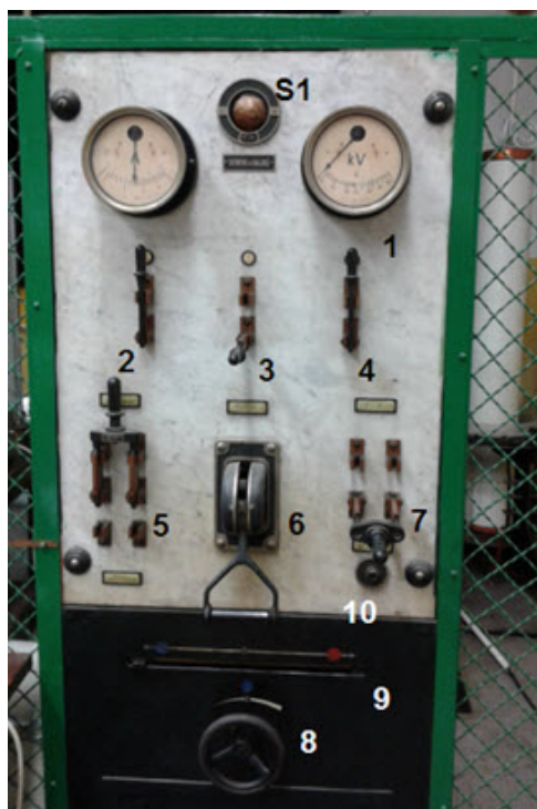
Slika 5.3: Komandna tabla za visokonaponski transformator do 100 kV
