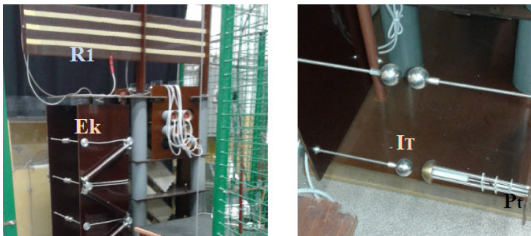
Slika 6.17: Udarni generator sa prikazanim otpornikom R_1 (levo) i detalj udarnog generatora sa troelektrodnim iskrištem I_T (desno)
