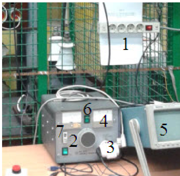
Slika 4.17: Fotografija napajanja preko regulacionog transformatora
